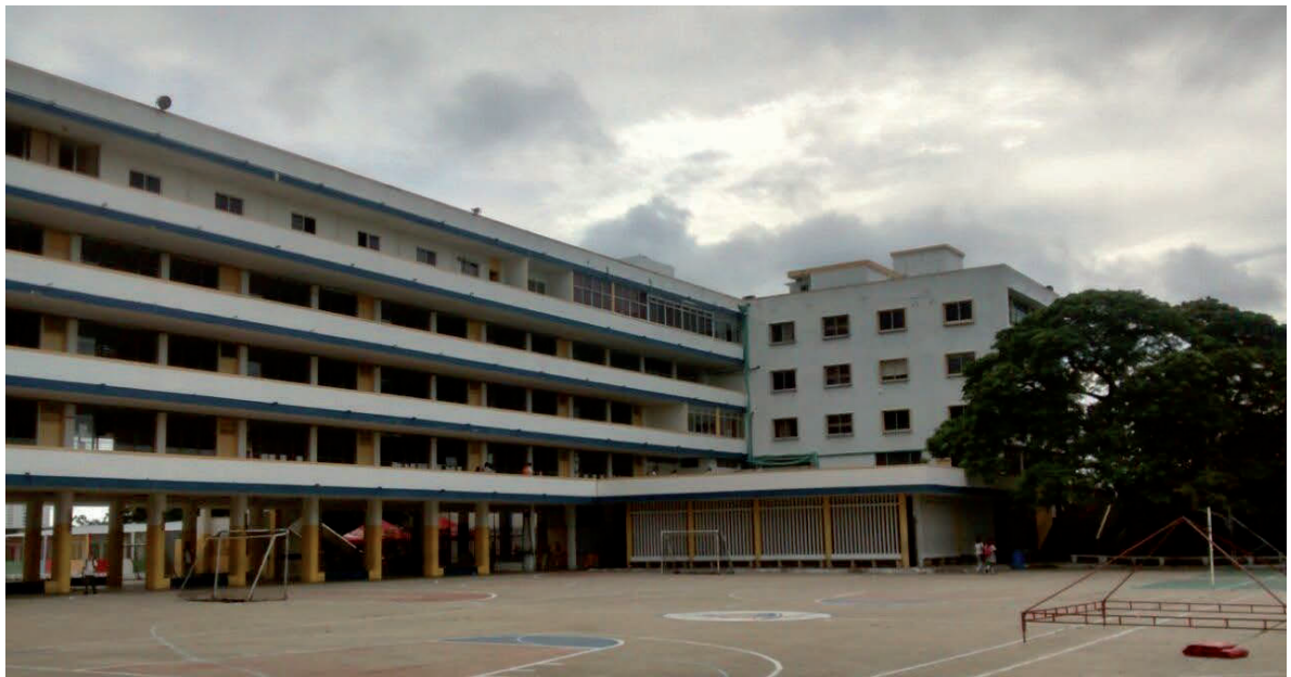
Imagen 275: Fotografías de la fachada norte del bloque de aulas que constituye la principal de este bloque que da hacia el patio de formación. Es notable el concepto de planta libre a nivel del primer piso que articula los servicios de baño y los tres cuerpos de escaleras del edificio. Este cuerpo central que es el bloque de aulas, está flanqueado en los costados este y oeste por dos volúmenes que proyectan terrazas hacia el patio de formación. El bloque de aulas con los corredores perimetrales a lo largo de los salones, los protege del sol de la mañana y de la tarde. En primer plano el patio de formación y canchas deportivas. Fuente: Ricardo Zabaleta Montes, 2016.
