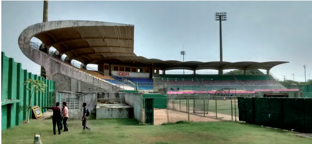
Imagen 239: Cubierta de la gradería principal del estadio de béisbol Once de Noviembre, BIC del ámbito nacional. Fuente: Archivo personal 2016.
