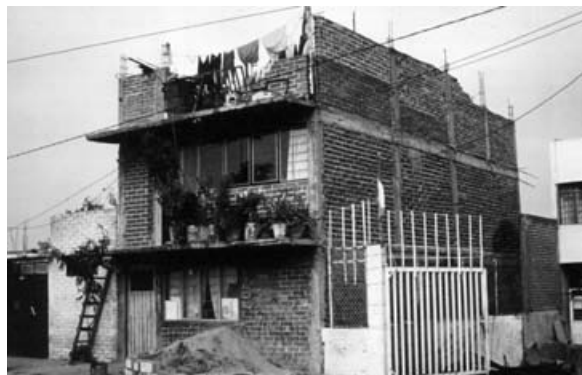
Foto 5. Vivienda en proceso de crecimiento y construcción. (Foto: Ribbeck, Eckhart y Padilla, Sergio..., op. cit. ).
